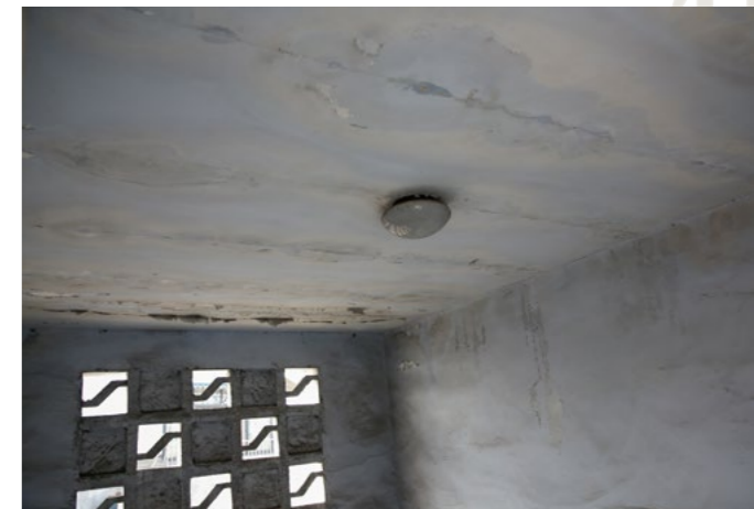
小红家的屋顶日晒雨淋、长年失修，导致房顶受潮漏水。爷爷说：“下雨水就积在这里，漏不下去，就要进水。”
