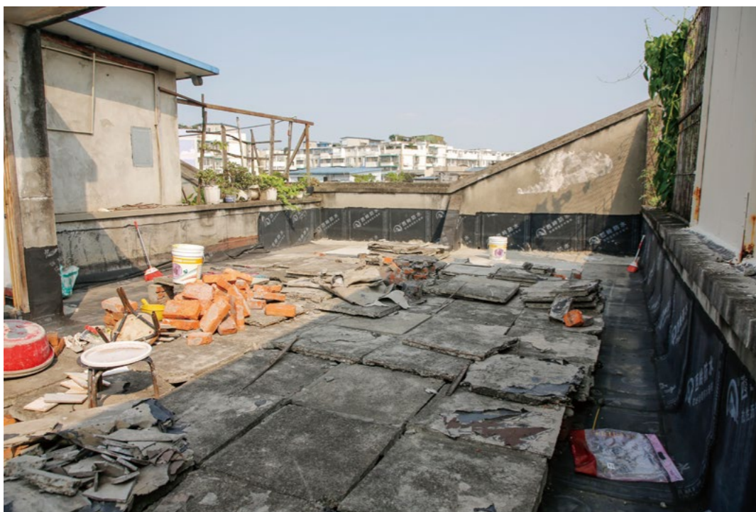
邻居家都将屋顶进行修缮，而小红爷爷因渐渐年长，已没有体力和能力修缮屋顶，只能任由其漏水。
