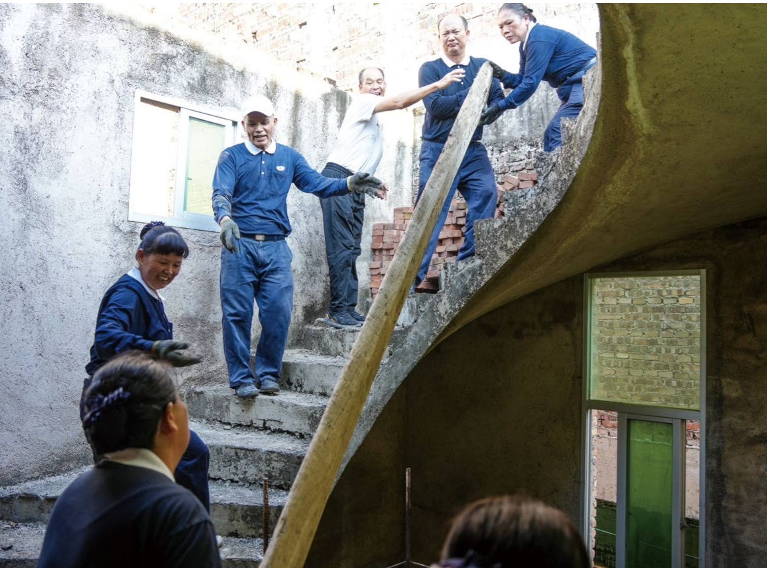
为搭建阁楼，志工手抬肩扛，默契配合，多人协力把四米多长的厚重的脚架踏板小心翼翼抬上顶层。摄影/陈丽英
