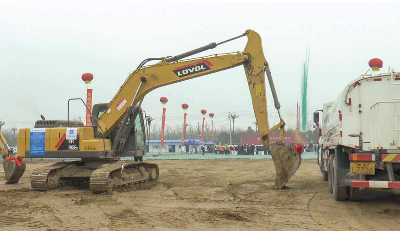
负责施工的中国建筑第七工程局土木工程公司挖下了援建张弓铺小学开工的第一坯土。摄影/齐岩
